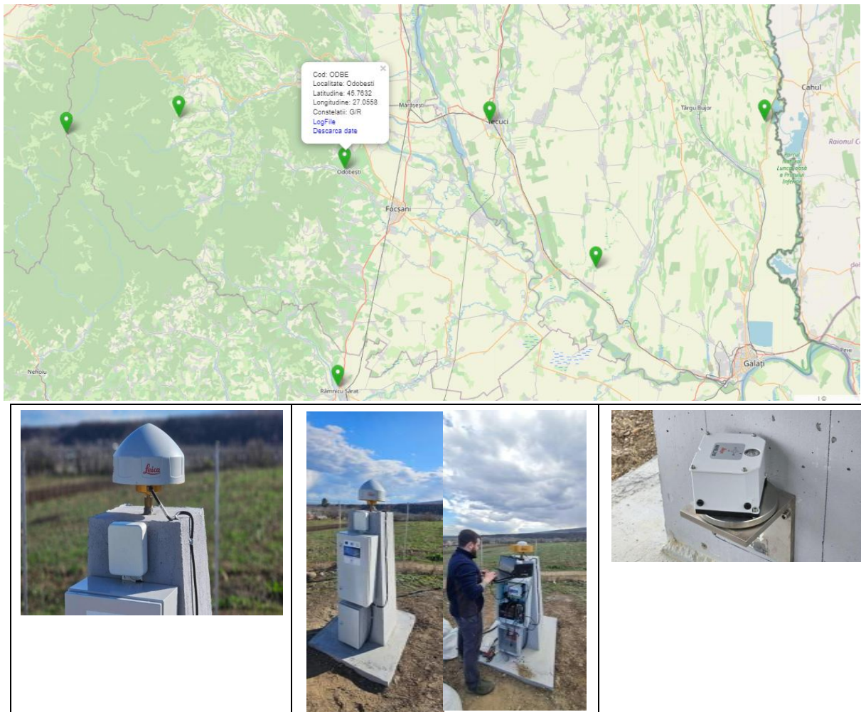
Figura 4-1.3.1-Locația și stația GNSS instalată la Odobesti
