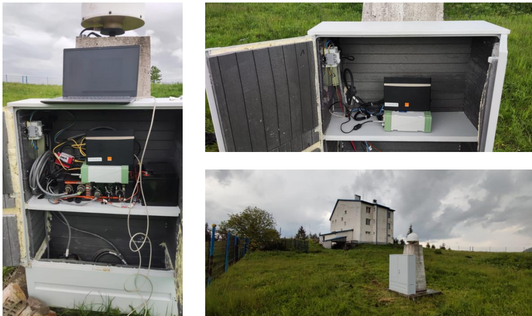
Figura 4-1.3.2 - Instalare stație GNSS la Roșia Montana.
